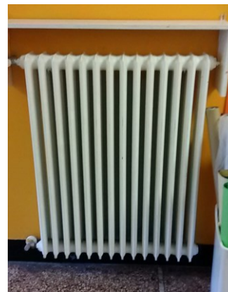
Figura 8.9- Particolare della radiatore
