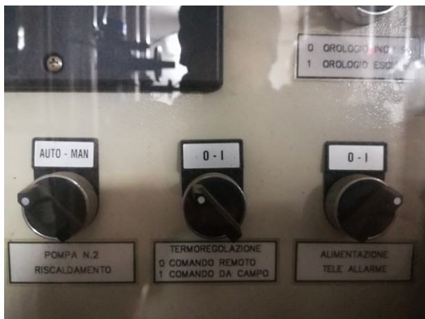
Figura 4.7 - Particolare del pannello di controllo di dell'impianto termico
