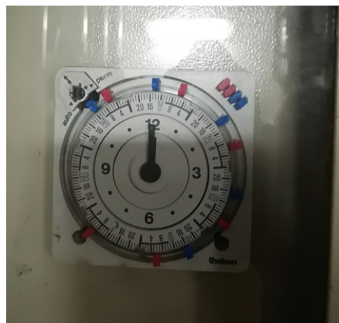
Figura 4.8 – Orologio a servizio dell'impianto termico
