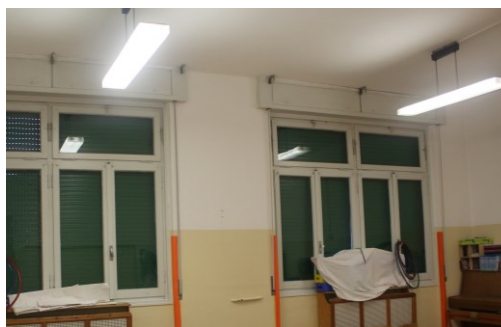
Figura 8.13- Particolare di lampade fluorescenti attualmente installate
