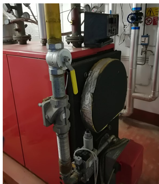
Figura 8.11- Particolare del generatore di calore attuale
