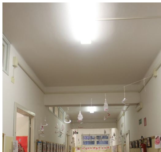
Figura 4.14 - Particolare dei corpi illuminanti ubicati nel vano scala
