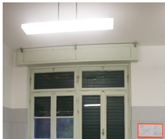
Figura 4.13 - Particolare dei corpi illuminanti ubicati nelle aule
